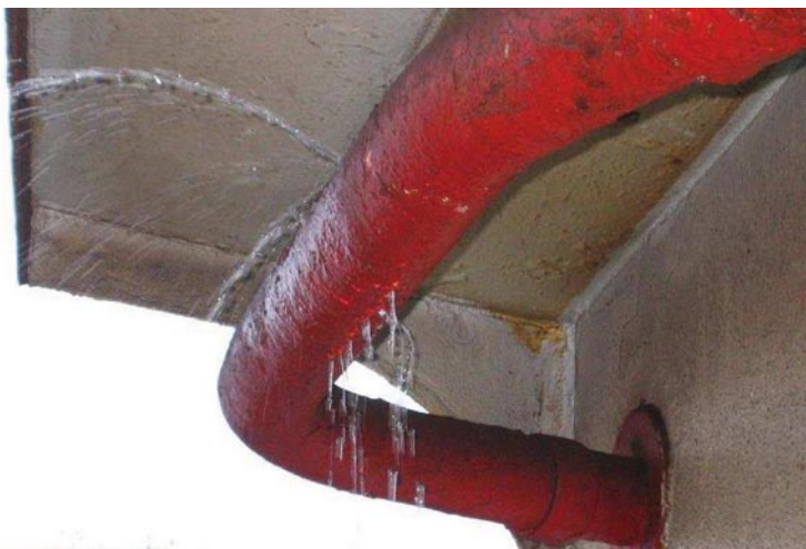
En läckande kylvattenledning var en av de brister som upptäcktes ombord på Panama-registrerade EEC Atlantic vid kontroll i Hamburg november 2008. Foto: Paris MOU.
