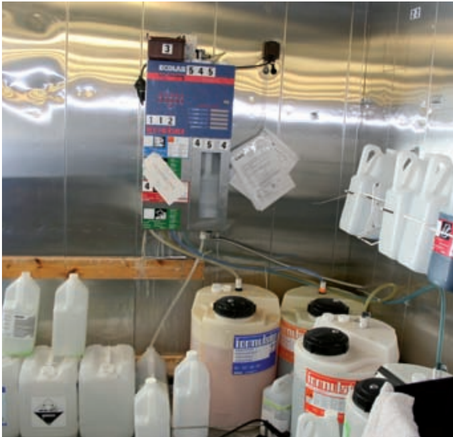
Rengöringsprodukter för köket blandas med hjälp av en doseringsapparat.
