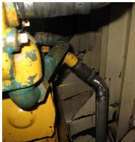
Kylvattenanslutningen som lossnade.
