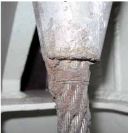
Vajer börjat krypa ut ur ändbeslag (närbild).
