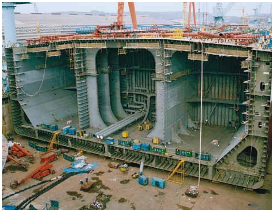
Brister som byggs in på varvet är ofta dyra och omständiga att ändra i efterhand. Foto Stena AB.
