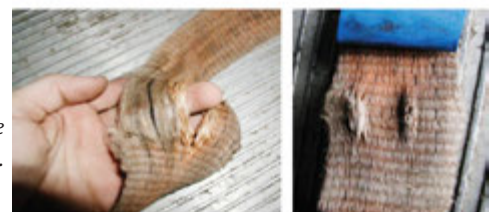
Rivskador i främst de tvärgående fibrerna.
