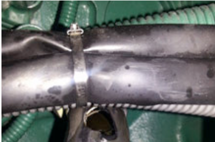
Hål i kylslang mellan motor och motorvärmare
