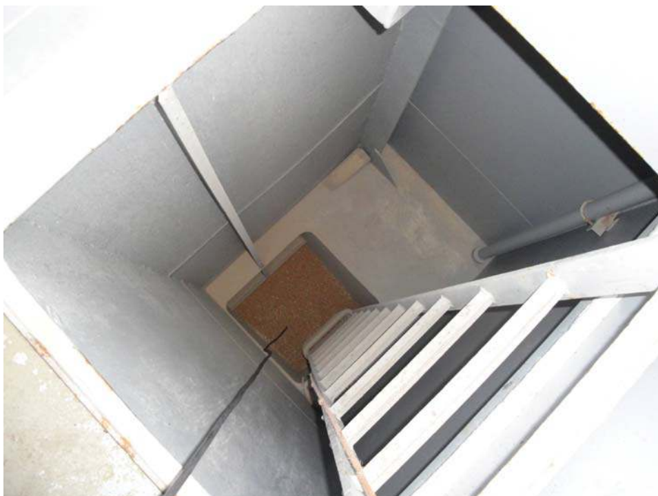
Bild 2 Trapphus till lastrum med vete, synligt i botten av trapphuset. Här uppmättes 300 ppm fosfin.
