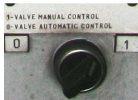
Strömställare till drencherpump som stod i fel läge.
